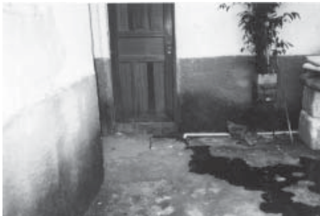
Vazamento de esgoto ameaça a saúde de todos os moradores e a própria solidez da construção
