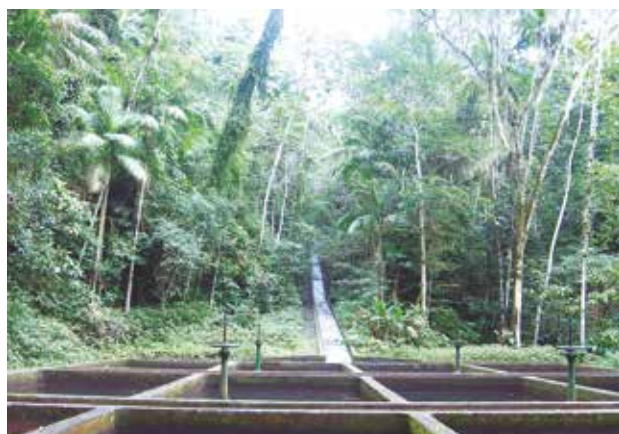
Estação de tratamento de água – PEPB
